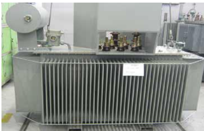
Slika br 7. Izgled transformatora 10/0,4 kV,630 KVA
