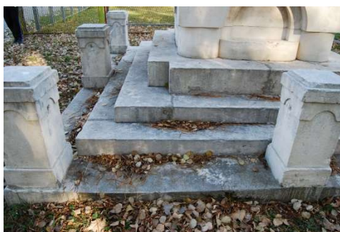
Оштећења на огради споменика
