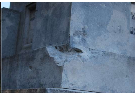
Оштећења на споменику
